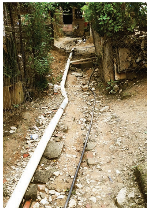
Kanalizacja i wodociąg w ubogiej dzielnicy.
